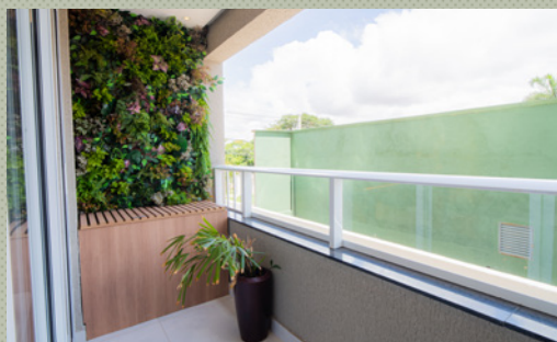
Guarda-corpo em alumínio e vidro laminado.
