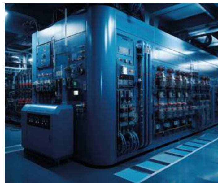
Gerador em 100% do empreendimento
