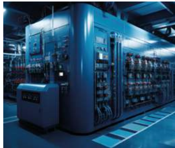
Gerador em 100% do empreendimento
